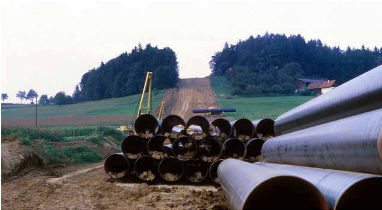
Abb.1 Pipelinetrasse der TAG II mit der Höhensiedlung Kogelfuchs im Hintergrund, 1987. Quelle: UMJ, AArchMk, Ortsakten. Foto: UMJ/G. Fuchs.
